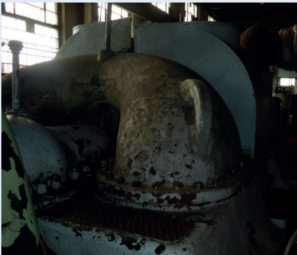
Паровая турбина, фотография Алексея Сонины, директора Инженерного центра АО РНПК
